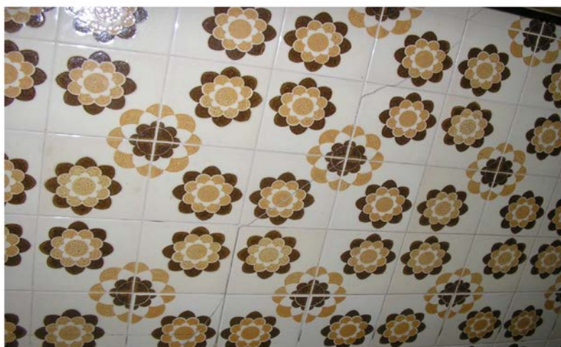
PAREDE DUMA CASA DE BANHO COM FENDILHAÇÃO, NOS AZULEJOS, DECORRENTE DA REMOÇÃO DUMA PAREDE NO ANDAR INFERIOR
