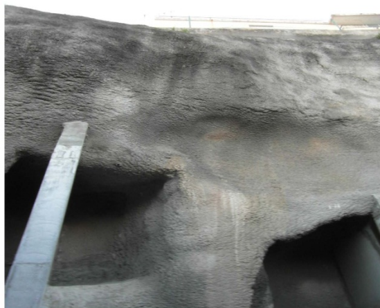
MANCHAS COLORIDAS, NA ESCARPA, ATESTANDO A ROTURA DO COLECTOR DE ESGOTO DOMÉSTICO
